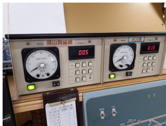
風速監視装置（桜水運転指令室）
